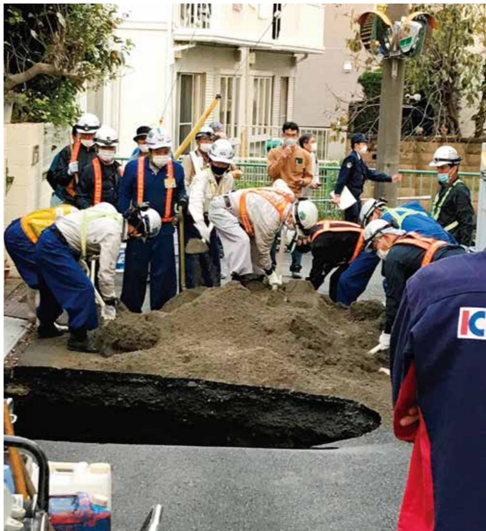
調布市で道路陥没した場所 (原田あきら都議撮影)
