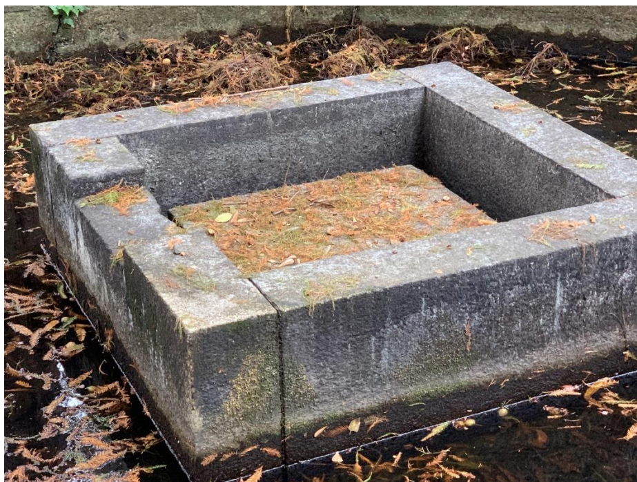
井戸ポンプの故障で水のくみ上げができなくなった
