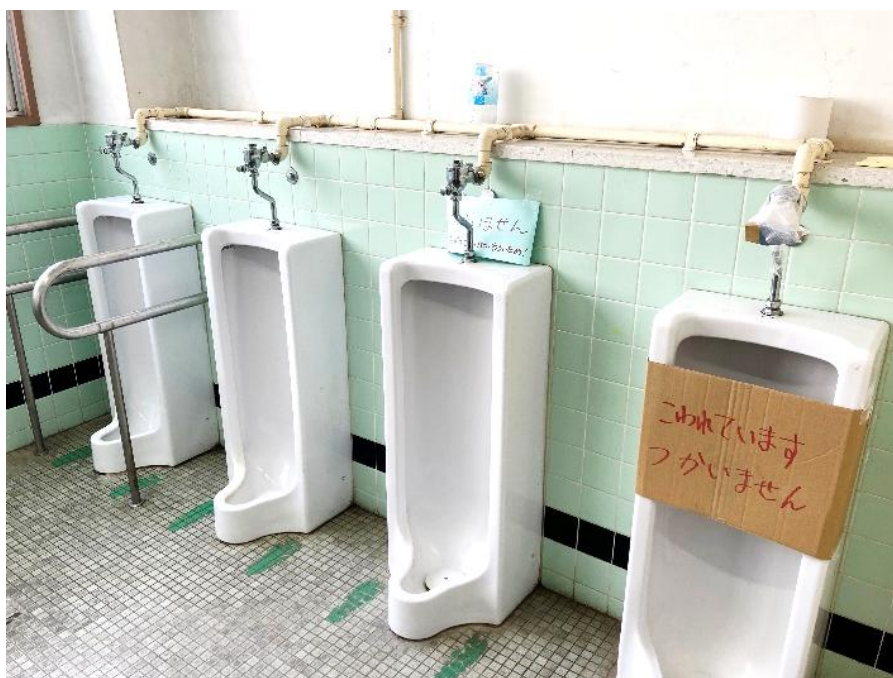
不具合による使用禁止の便器が並び、床のタイルや排水口から臭いが立ち上る。(2026 年 6 月)
