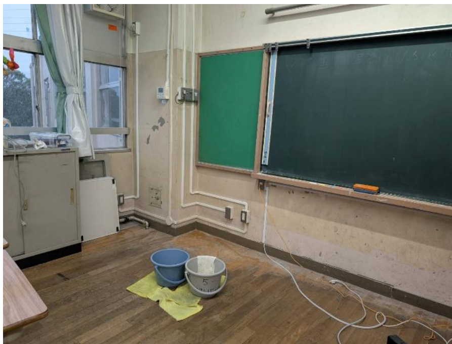
黒板の前の雨漏りにより、授業に使うモニター等が置けない状況。(2026 年 9 月)
